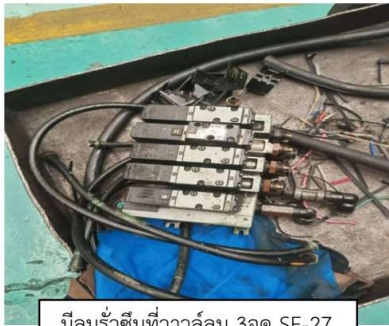
มีลมรั่วซึมที่วาล์วลม 3จุด SE-27
