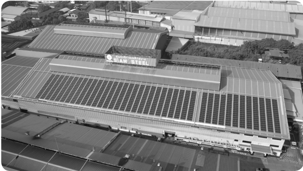
โรงงาน 1 ให้กำลังการผลิตไฟฟ้า 350 kWp
