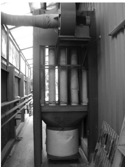
ระบบการจัดการฝุ่นบริเวณพื้นที่ปฏิบัติงาน
